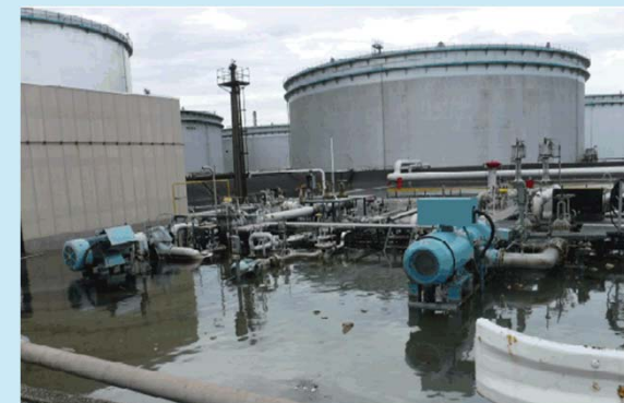
（製油所で発生した冠水被害）
