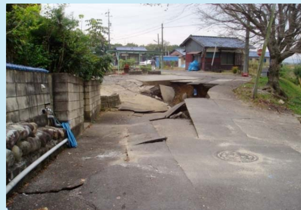
大規模陥没事故 (岐阜県御嵩町)
